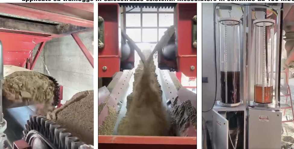
■ Impianto per la produzione di calcestruzzo con sistema di pesatura dinamica applicate su tramogge in calcestruzzo esistenti. Mescolatore in continuo da 150 mt/c
